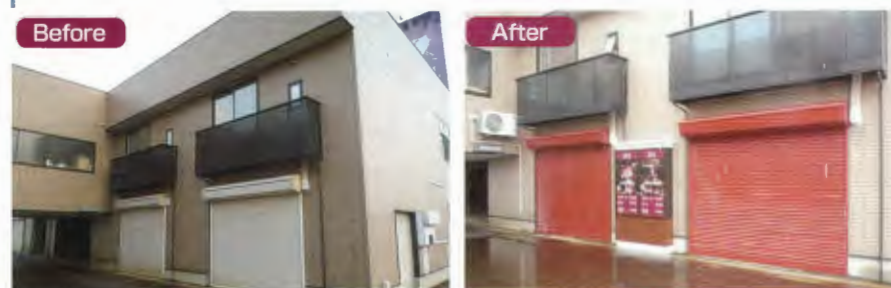
車庫は暖色系の塗装を実施するとともに、内照式の客室パネルを設置し、ルーム空間を効果的にアピール
